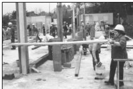
Nella foto in alto la nuova sede dei Testimoni di Geova e qui sopra un momento della costruzione ad opera dei volontari.
